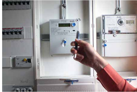
Ableseung der Zählerstände vor Ort
