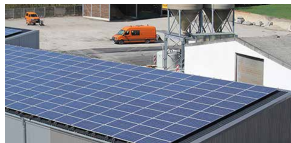
Photovoltaik-Anlage auf der Fahrzeughalle
