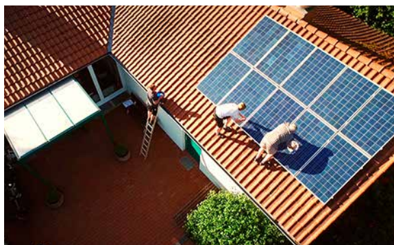
Solar-Anlage für das Dorfgemeinschaftshaus Reiffenhausen
