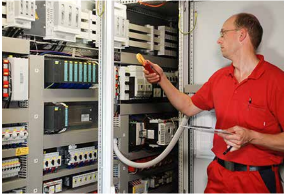
Messung an Niederspannungs-Schaltanlage
